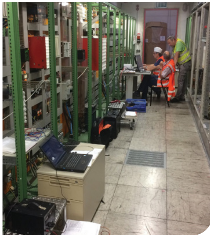
Schlüsselfertige Inbetriebnahme und Anlagenabwicklung von SPS-Technik Vorort
