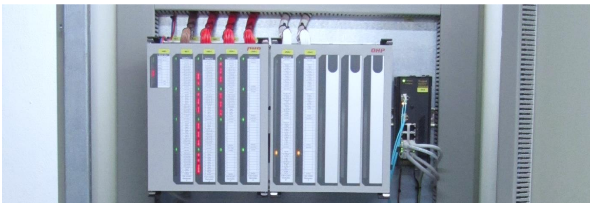
Abb. 1 OHP @250 im Schaltschrank beim WDR
